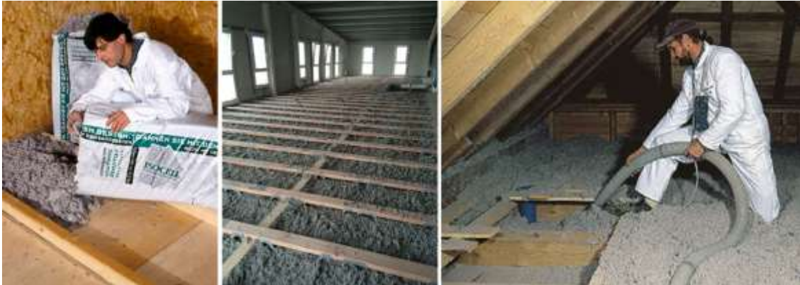
/cellulóz hőszigetelés- fotó Internet:szolnokihoszigeteles.hu/
